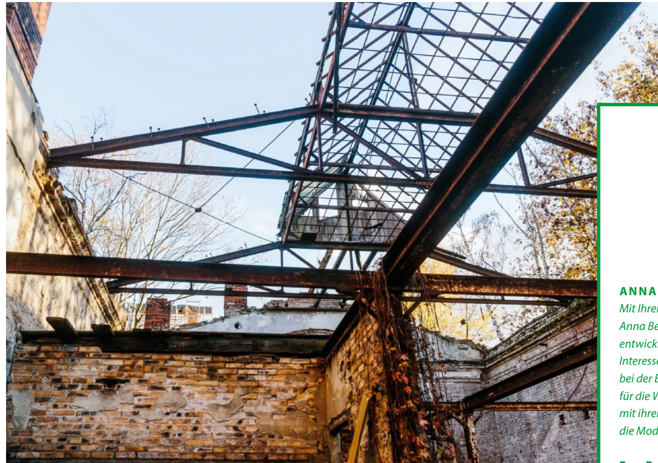
Das Dach der alten Sammelhalle existiert nicht mehr. Viele Gebäudeteile müssen gestützt werden
