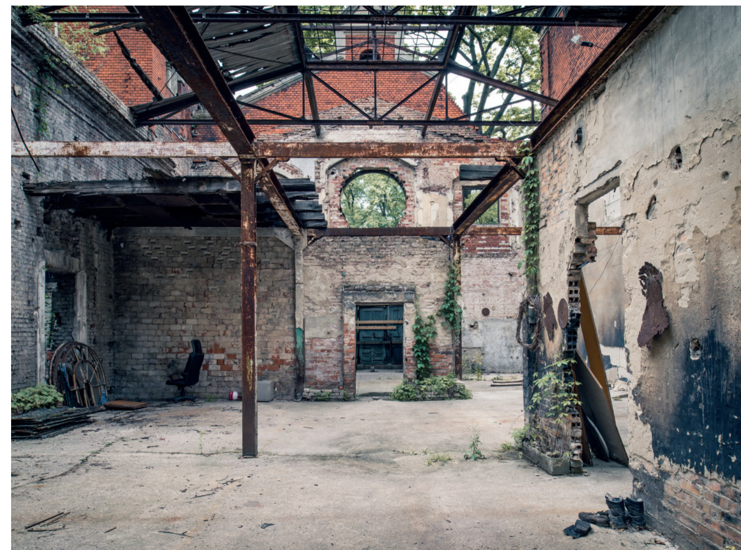
rechts oben, unten: Die Sammelhalle wird saniert und kann wieder genutzt werden. Die noch erhaltenen Bauteile werden gesichert und bleiben sichtbar.
