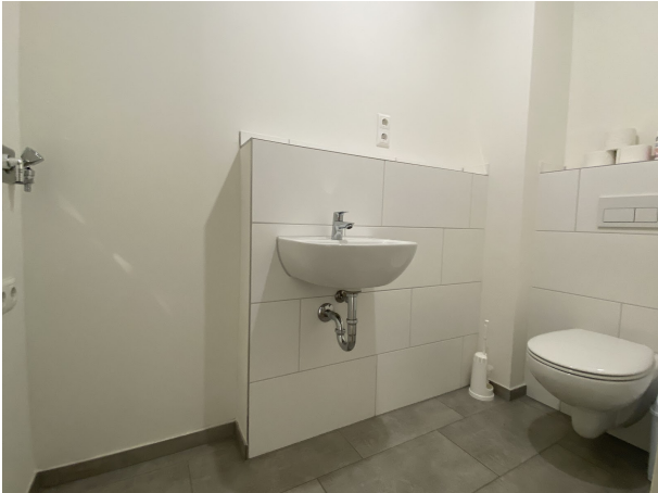
Wc mit Waschmaschinenanschluss
